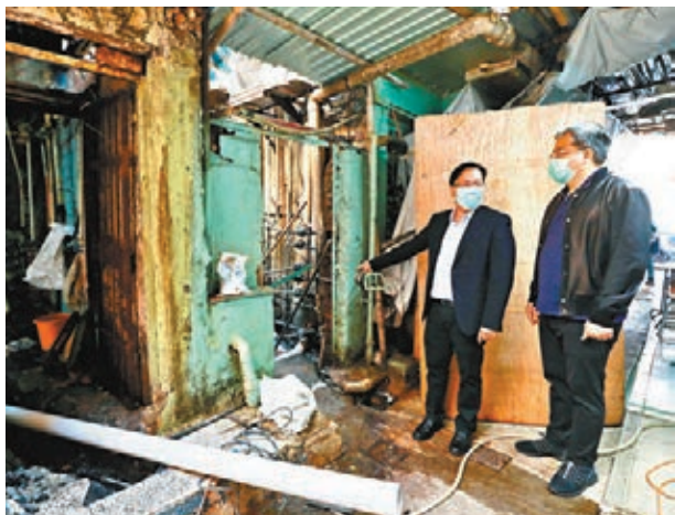
●專家與記者實地巡查期間，巧遇石硤尾街一幢大廈正在更換地下渠管，發現工人未有按法例規定使用金屬渠管，改用塑膠渠管。 香港文匯報記者攝
