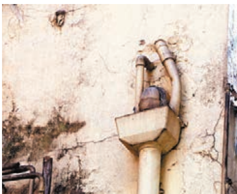
●污水管開放式水斗接駁，也非法將廢水管接駁污水管。 香港文匯報記者攝
